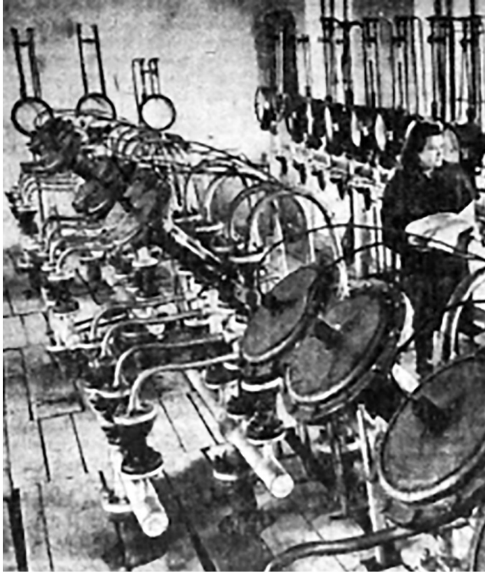
Автоматизированная воздухораспределительная установка на укрупненном промысле «Бухта Ильича».
