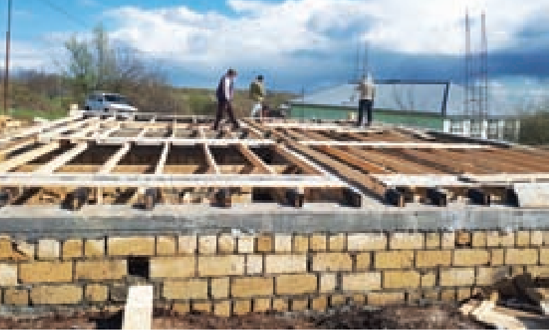
В Исмаиллинском районе продолжают меры по устранению последствий землетрясения, произошедшего 5-6 февраля.
